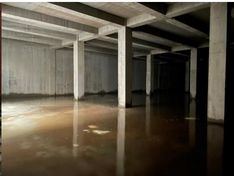
新北高中地下貯留設施
