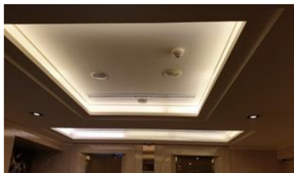
4. A 棟梯間照明#2
