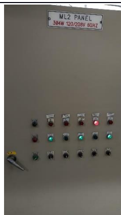
A 棟大樓配電盤(外觀)
