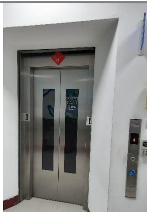
2. A 棟大樓電梯
