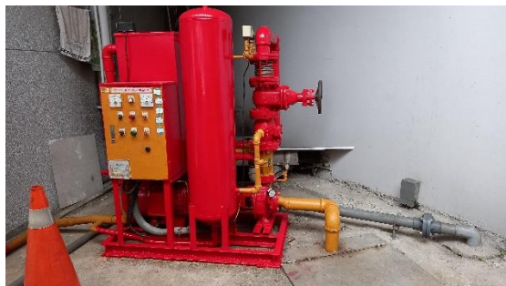
1. A 棟消防泵
