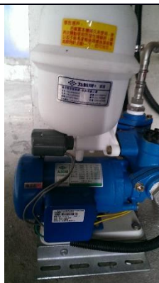
1. A 棟揚水泵#2
