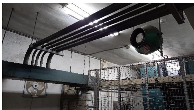
3. A 棟地下停車場抽排風機
