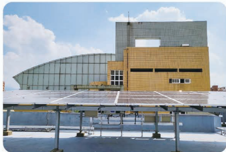
▲ 蘆洲區蘆江國小的太陽光電板
