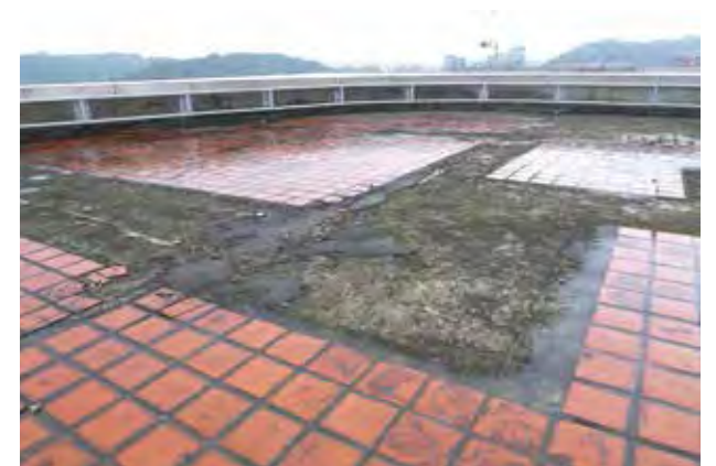
↑老舊的屋頂一般防水層已被破壞。
